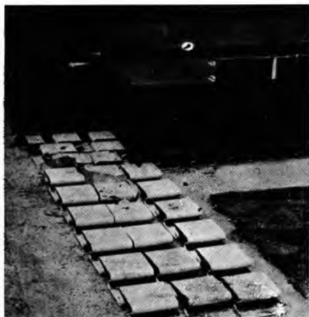
Sl. 87. Polaganje unutarnjeg zida studija na čelične opruge koje moraju izdržati cijelu težinu studija
