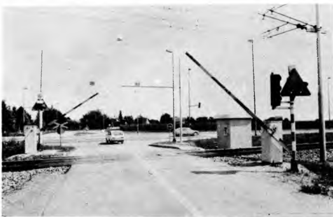
Sl. 16. Vanjski dijelovi signalno-sigurnosnih uređaja u trenutku postavljanja polubranika
