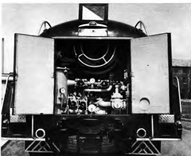
Sl. 35. Pumpna stanica auto-cisterne
